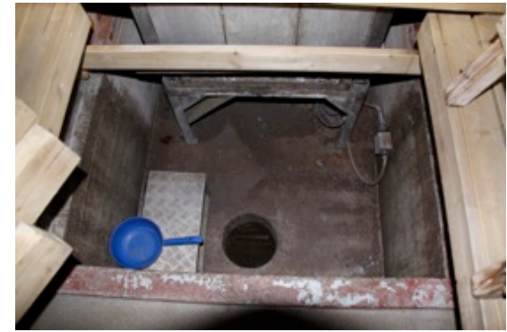
Ison saunan löylyvesikaivo kiukaan edessä
